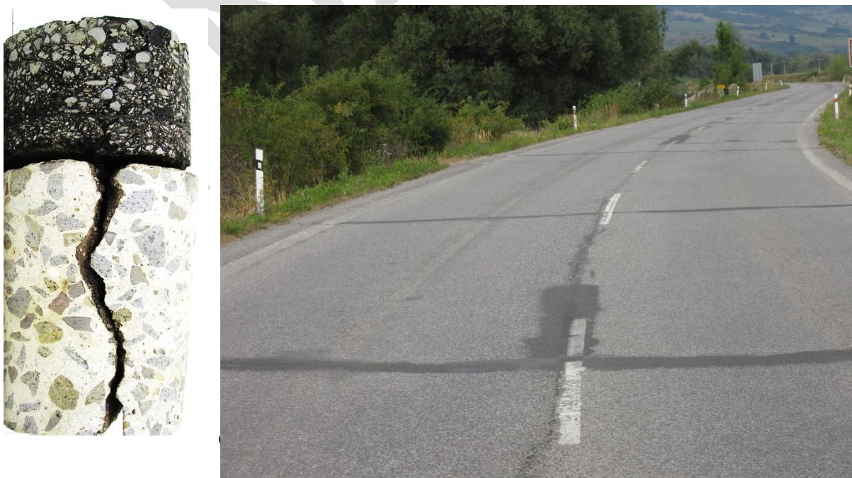
Obrázok 1 – Reflexné trhliny v asfaltových vrstvách
