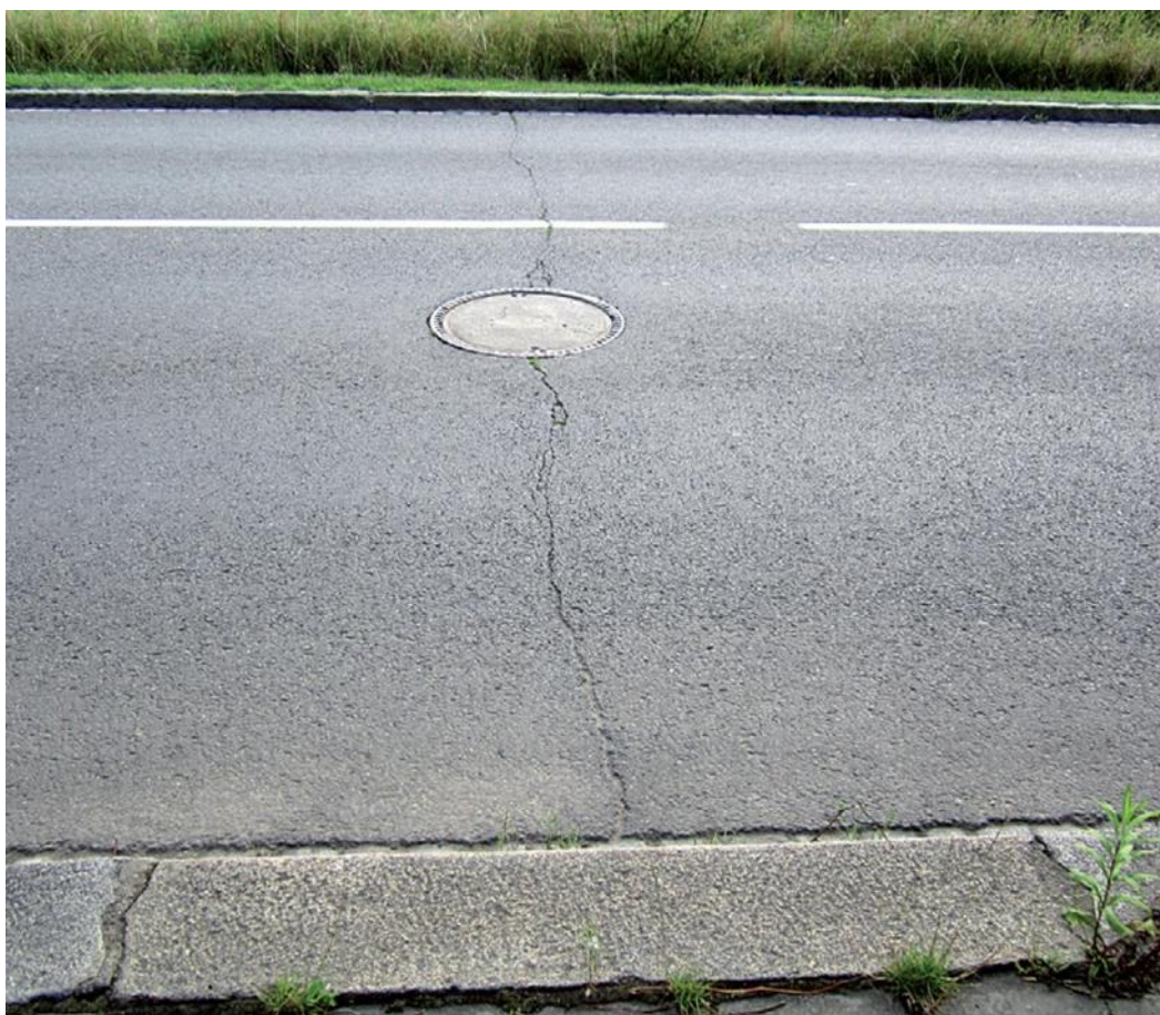
Obrázok 7 – Nízкотеплотná (mrazová) trhlina
