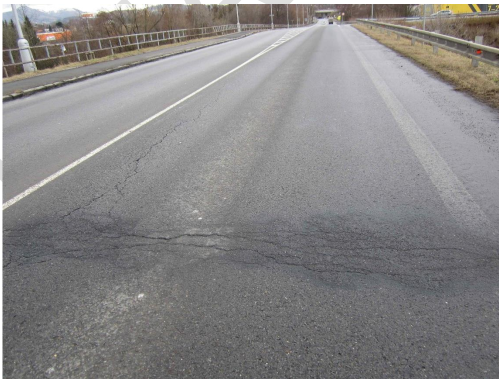
Obrázok 3 – Priečna trhlina rozvetvená prechádzajúca do trhliny sieťovej
